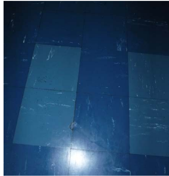
Illustration 11 : Dalle de sol vinyle amiante (Crédit : LAFP)
