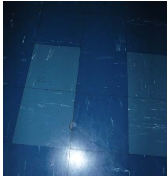
Illustration 11 : Dalle de sol vinyle amiante (Crédit : LAFP)
